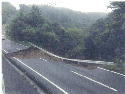
被災直後状況（平成30年7月7日）
