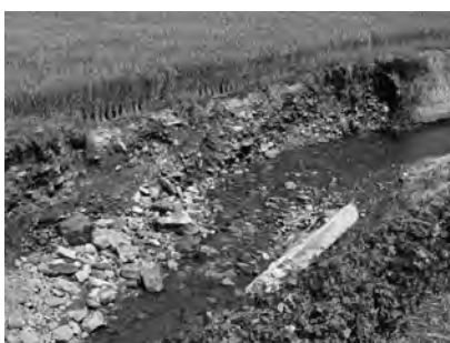
台風10号による被害(令和6年9月)
