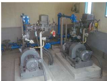
熊野地区第1送水ポンプ
