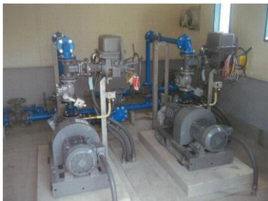
熊野地区第1送水ポンプ
