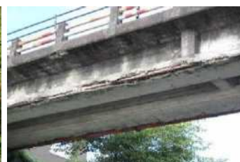
C2: 剥離・鉄筋露出
