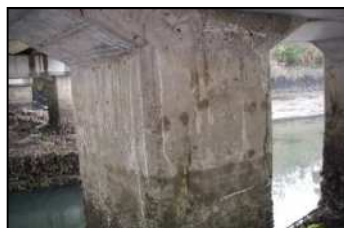
S1: 比較的大きなひび割れ・剥離
