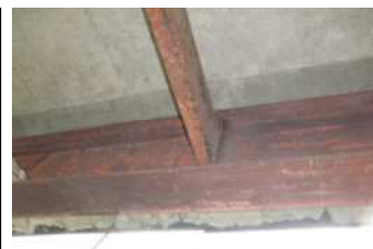
S2: 鋼材部の劣化・腐食
