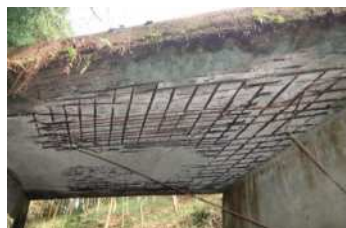
E1: 広範囲に剥離、鉄筋腐食
