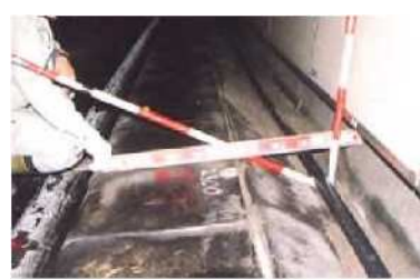
写真-2.3 変形・移動・沈下
