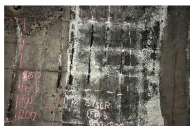
写真-2.4 鋼材腐食
