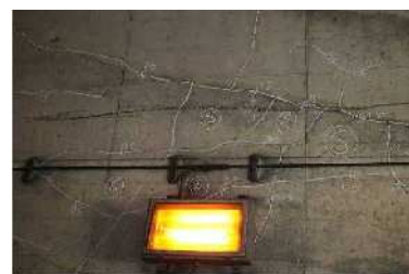
写真-2.6 ひび割れ
