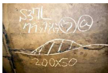
写真-2.5 うき・はく離
