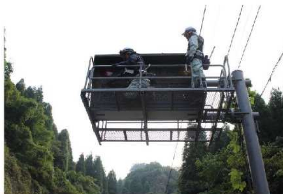
写真-4.3 警報表示板点検状況
