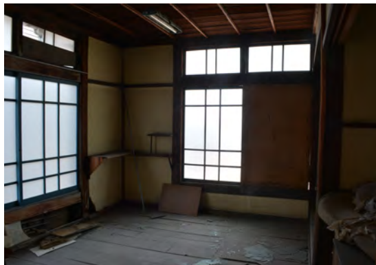
活用されず老朽化する佐野家病棟
