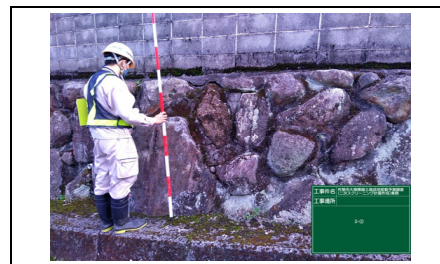
写真3 盛土下端部(末端先) 石積擁壁のひび割れ W=20mm
