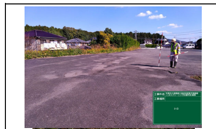
写真11 盛土境界部付近 地面の凹凸
