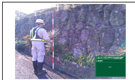
写真2 盛土下端部(末端先) 石積擁壁のひび割れ W=15mm
