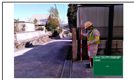
写真6 盛土境界部付近 塀の傾き
