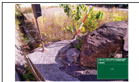
写真9 盛土境界部付近 擁壁の開口
