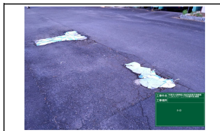
写真10 盛土外状況 地面の凹凸
