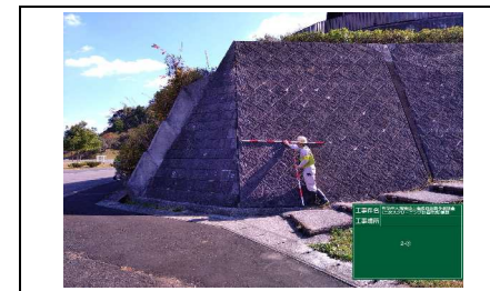
写真12 盛土内状況 擁壁のひび割れ W=20mm
