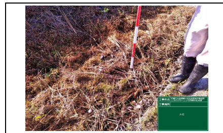
写真7 盛土下端部(小段) 法面からの湧水
