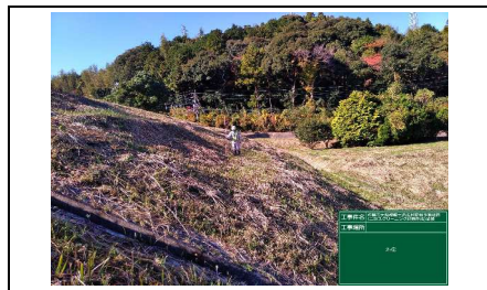
写真6 盛土下端部(法面) 法面の表層崩壊跡
