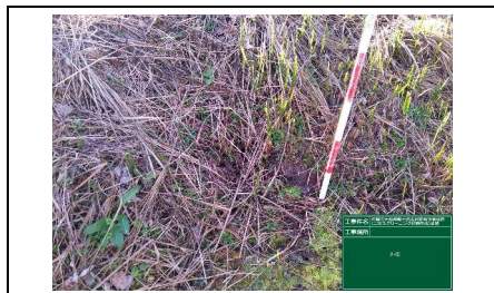
写真5 盛土下端部(小段) 法面からの湧水
