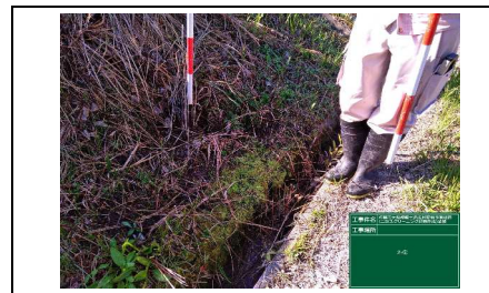
写真3 盛土下端部(小段) 法面からの湧水
