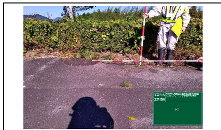
写真9 盛土境界付近 地面の凹み
