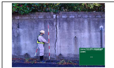
写真14 盛土境界付近 擁壁のひび割れ W=30mm
