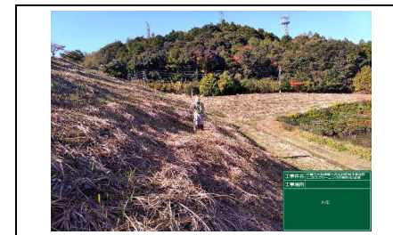
写真4 盛土下端部(法面) 法面の表層崩壊跡
